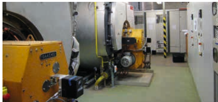
Neues Speichermanagement steuert die Brennerleistung: Je nach Ladezustand des Speichers erhöht oder reduziert die Steuerung die Heizkesselleistung.
